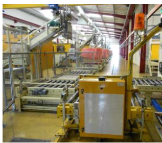
Navette d'approvisionnement et d'évacuation des contenants
