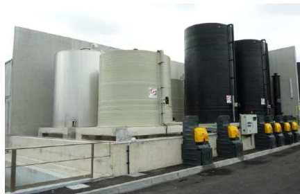
Station de stockage de produits chimiques
